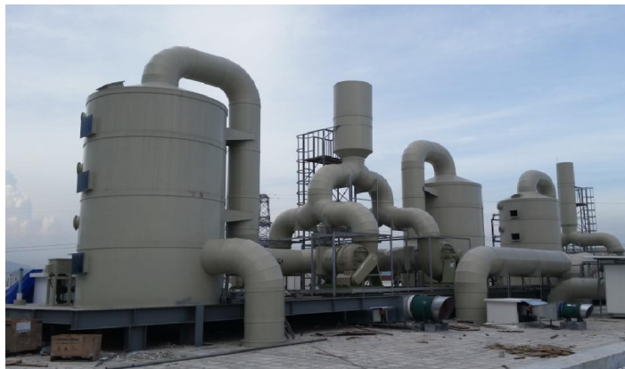
电镀废气项目
